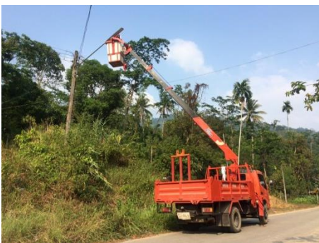
๘. โครงการขยายเขตไฟฟ้าแรงต่ำในเขต ตำบลเกียร์
